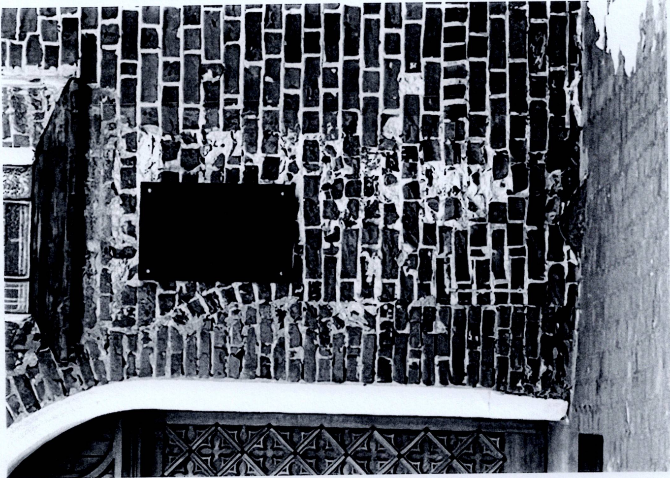
Fot. 34 Przasnysz. Kościół par. p.w. Wniebowzięcia NMP – fragment zniszczonej ściany
